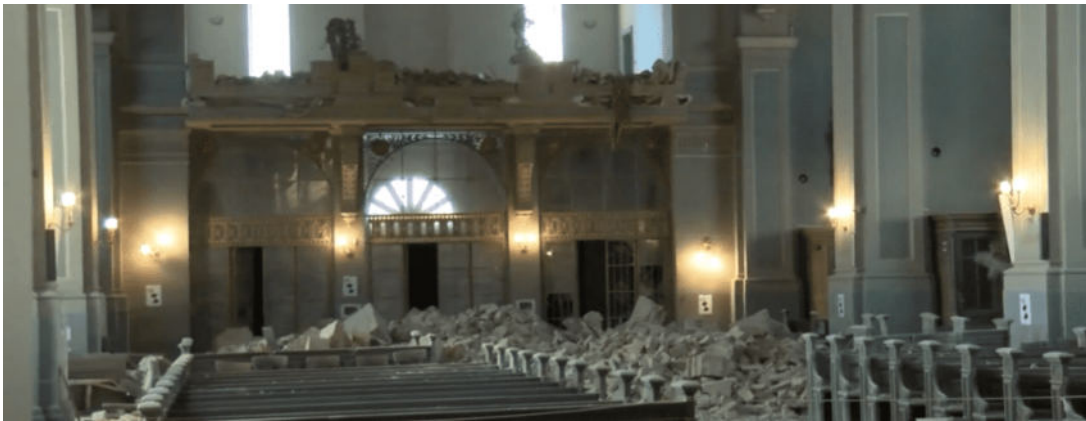
Bazilici u Palmotićevoju u potresu je srušena trećina svoda i teško oštećen kor; foto: laudato.hr
