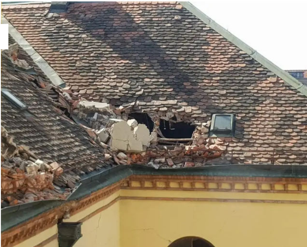
Svod hodnika južnoga krila na drugom katu srušen je zbog urušavanja tri dimnjaka kroz krovšte; foto: MUO
