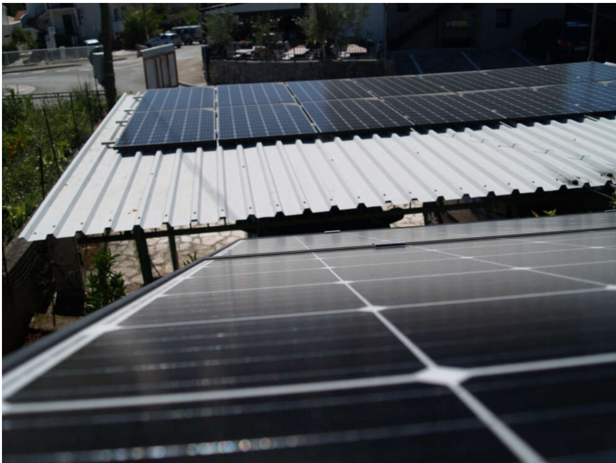
Solarna elektrana na krovu Foto: V. Piršić
