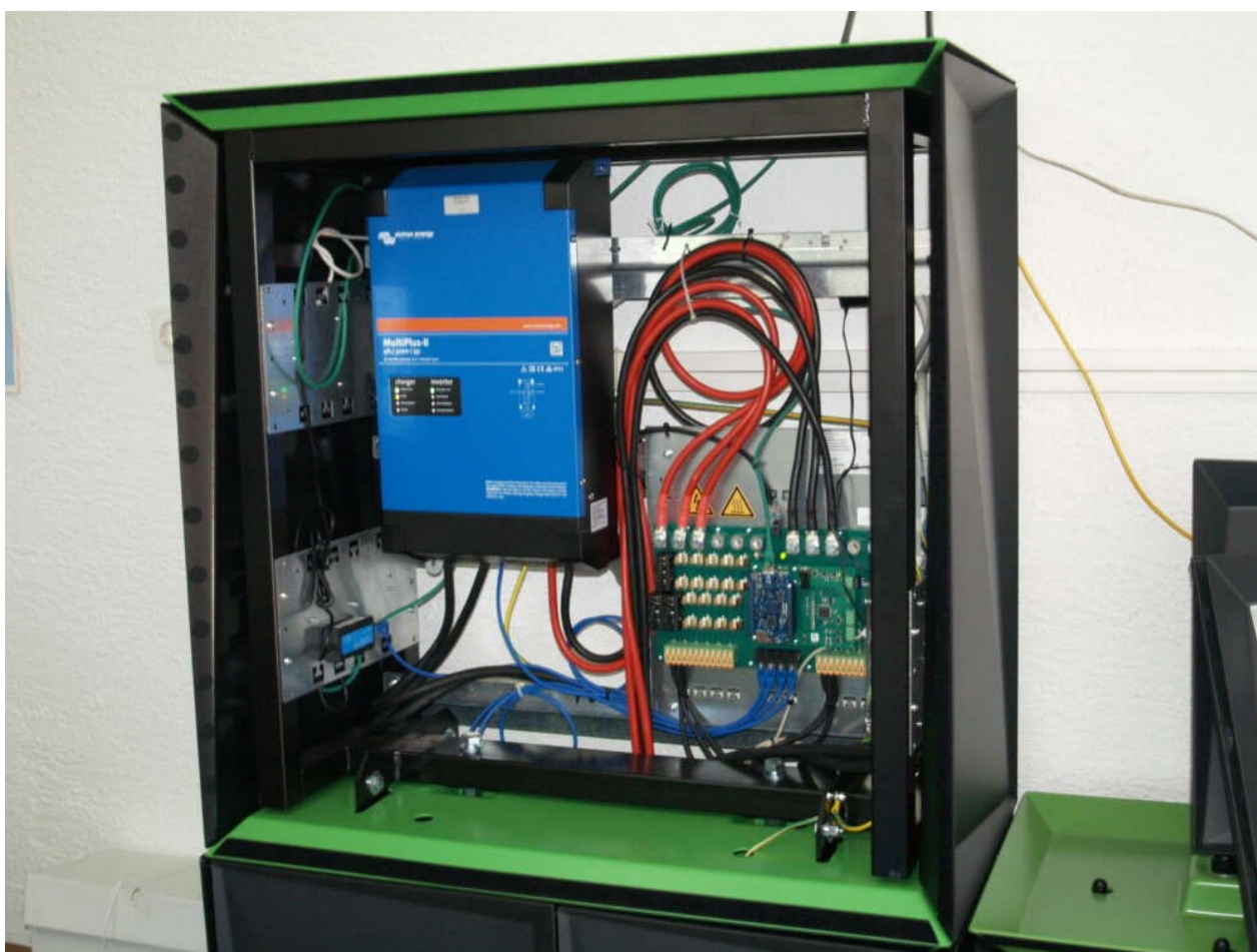
Instalacije u kući Foto: V. Piršić
